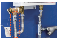
旧モデルの排水処理配管
